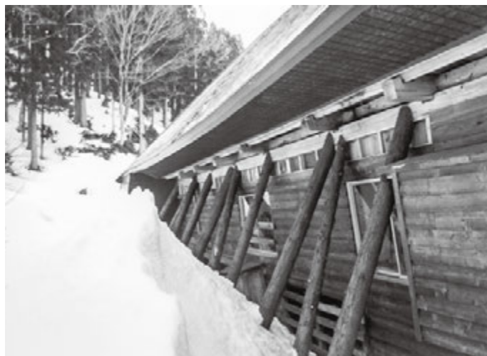
豪雪に耐えた被災住宅
