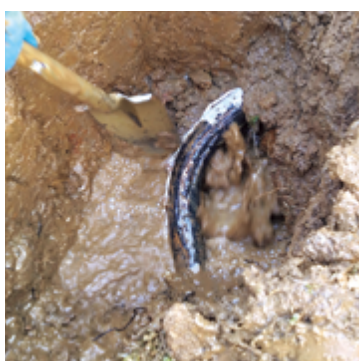
老朽化により破損した中土水道
