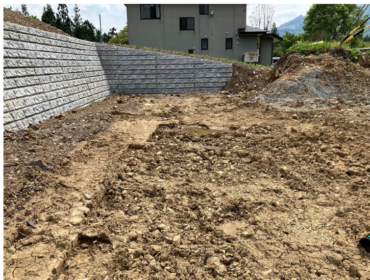
写真 1-1 土質は粘土質礫でマトリックスは軟弱であるが礫分が多く、SW 貫入試験では貫入出来ない
